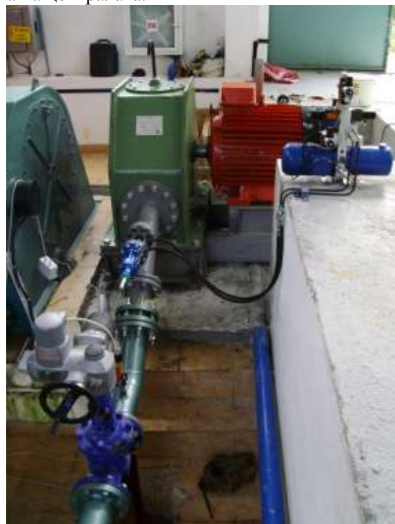
Фиг. 6. Хидроагрегат №2 в машинната зала
